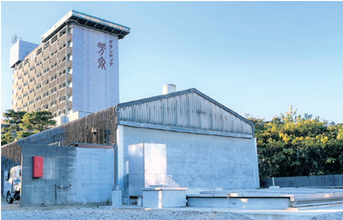
グランディア芳泉2号機 (福井県あわら市) 使用燃料: 県産間伐未利用材の切削/チップサイロ容量/方式 81m/地下式 最大出力: 300kW 運転開始: 2021年6月17日
