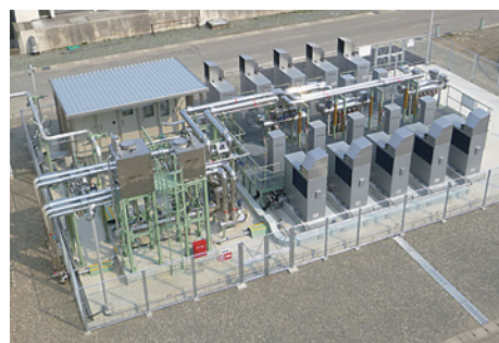
丸頭竜川浄化センター 消化ガス発電設備 (福井県坂井市) 消化ガス発電(コージェネレーション型) マイクロガスエンジン発電機25kw×10基 運転開始: 2015年3月14日
