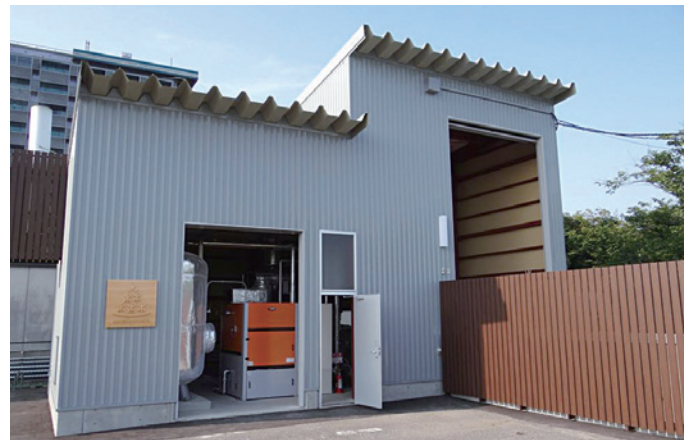
グランディア芳泉 (福井県あわら市) 使用燃料: 県産間伐未利用材の切削/チップサイロ容量/方式 30m/半地下式 最大出力: 200kW 運転開始: 2015年4月20日
