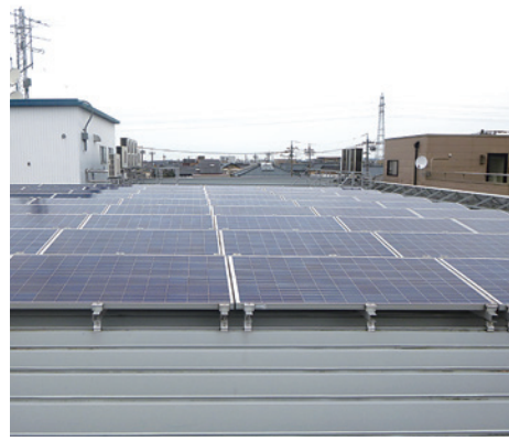
マルツニの宮太陽光発電所 (福井県福井市) 自社発電 マルツパーツ館ニの宮店屋上 最大出力: 20kW 運転開始: 2012年8月20日
