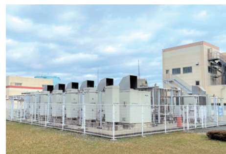
日野川浄化センター 消化ガス発電設備 (福井県福井市) 消化ガス発電(コージェネレーション型) マイクロガスエンジン発電機25kw×12基 運転開始: 2015年3月14日
