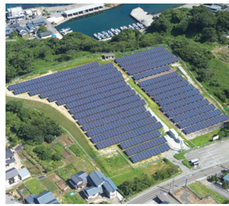
鷹巣マルツ太陽光発電所 (福井県福井市) 自社発電 敷地面積: 17,088㎡ 最大出力: 1,103kW 運転開始: 2014年6月18日
