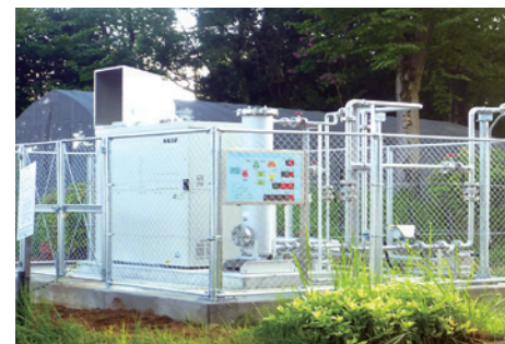
マルツ越前家久浄化センター 消化ガス発電設備 (福井県越前市) 消化ガス発電(コージェネレーション型) マイクロガスエンジン発電機25kw×1基 運転開始: 2017年8月31日
