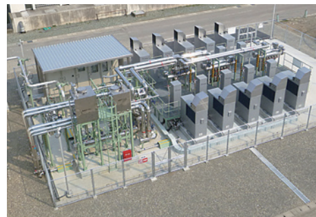
九頭竜川浄化センター 消化ガス発電設備 (福井県坂井市) 消化ガス発電(コージェネレーション型) マイクロガスエンジン発電機25kw×10基 運転開始: 2015年3月14日
