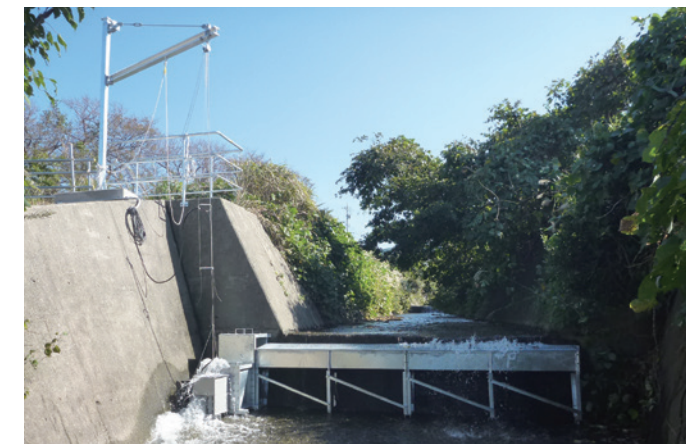
鷹巣マルツマイクロ水力発電所 (福井県福井市)
