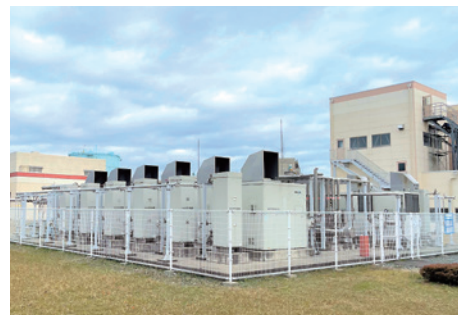
日野川浄化センター 消化ガス発電設備 (福井県福井市) 消化ガス発電(コージェネレーション型) マイクロガスエンジン発電機25kw×12基 運転開始: 2015年3月14日
