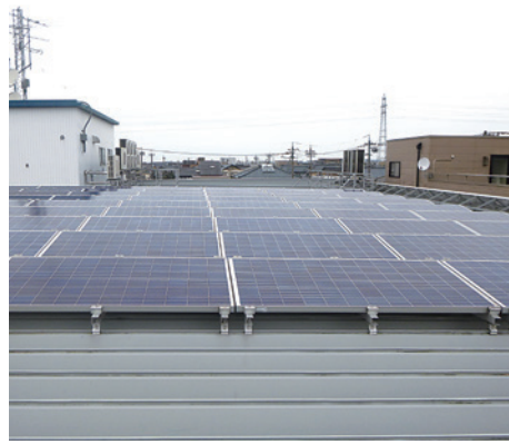
マルツニの宮太陽光発電所 (福井県福井市) 自社発電 マルツパーツ館ニの宮店屋上 最大出力: 20kW 運転開始: 2012年8月20日
